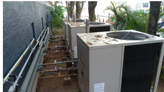
Figura 1 – GAHPs instalados no local piloto e parte dos transmissores de temperatura.
